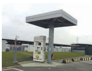
Stazione di rifornimento dell'idrogeno
