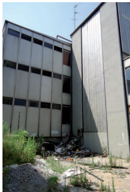
Vista esterna sul retro con annessa discarica
