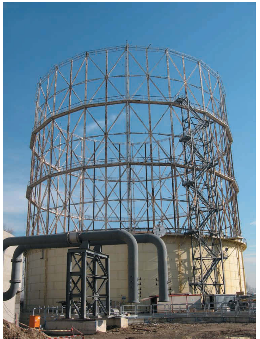
Il gasometro di via Cavriana. Accanto sta sorgendo l'impianto di cogenerazione per il tele riscaldamento. Vedi servizio a pag. 5
